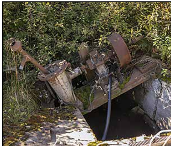
Funksjonen til Silhuset ble etter hvert mer som pumpehus enn som råvannfiltrering av vannet de siste tiårene som anlegget var i drift. Et synlig bevis for dette er den gamle pumpen som står rett utenfor huset i dag. Foto: Knut Erik Skarning
